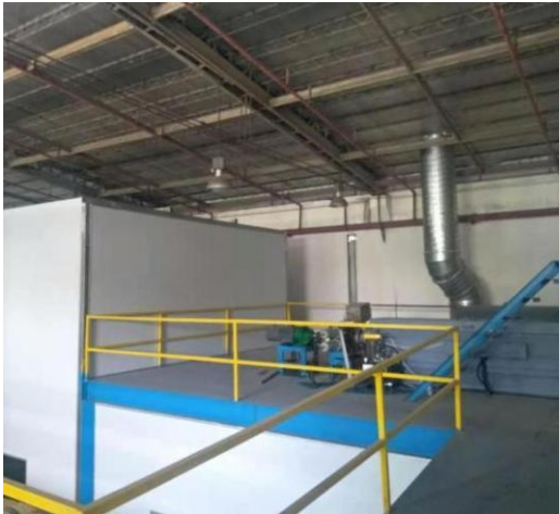
熔喷布自带风机，出口连接废气收集管道，穿过房顶汇合后进入两级活性炭吸附装置
